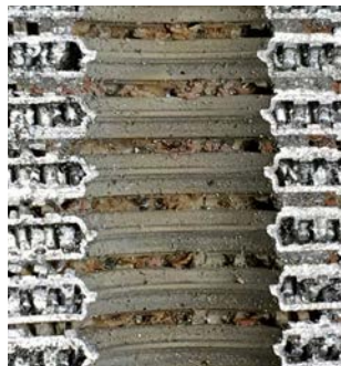
Canale di afflusso con impurità
